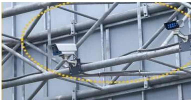
ระบบควบคุมการใช้ความเร็วบนทางหลวง (SE)
